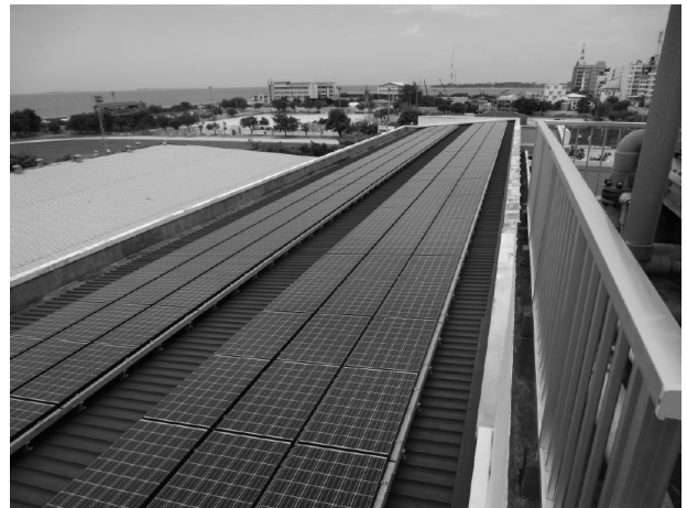
無償資金協力(モルディブ・マレ島におけるクリーンエネルギー促進計画、2010年)により設置された太陽電池モジュール
